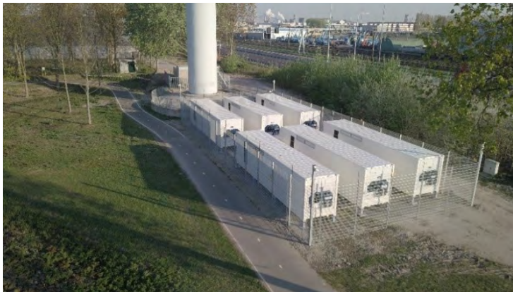
FIGUUR 6 VOORBEELD VAN EEN 10 MWH LI-ION BESS BIJ WINDPARK HARTELKANAAL 5 IN ROTTERDAM
