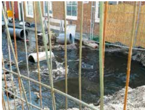
Figuur 3.7 Foto locatie breuk persleiding: water op straat
