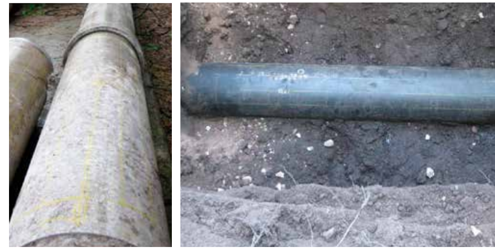
Figuur 5.5 Met krijt aangegeven meetlijnen bij uitwendige radarinspectie. Links is een meting van een uitgenomen AC-buis op het maaiveld. Rechts een AC-buis in de bodem. Tekst en foto overgenomen uit Weert, van der et al., (2022).
