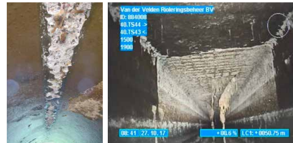
Figuur 5.2 Links: Kruinrotatie in betonnen persleiding in Oudenbosch (overgenomen uit TNO 2016 R10427) Rechts: H 2 S-aantasting in Riool-zuid nabij Eindhoven. Foto Waterschap De Dommel.
