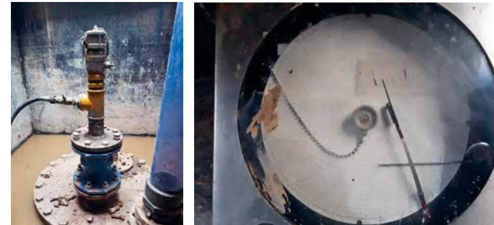
Figuur 4.19 Drukmeting op afsluiter (links) en schrijvende meter (rechts)
