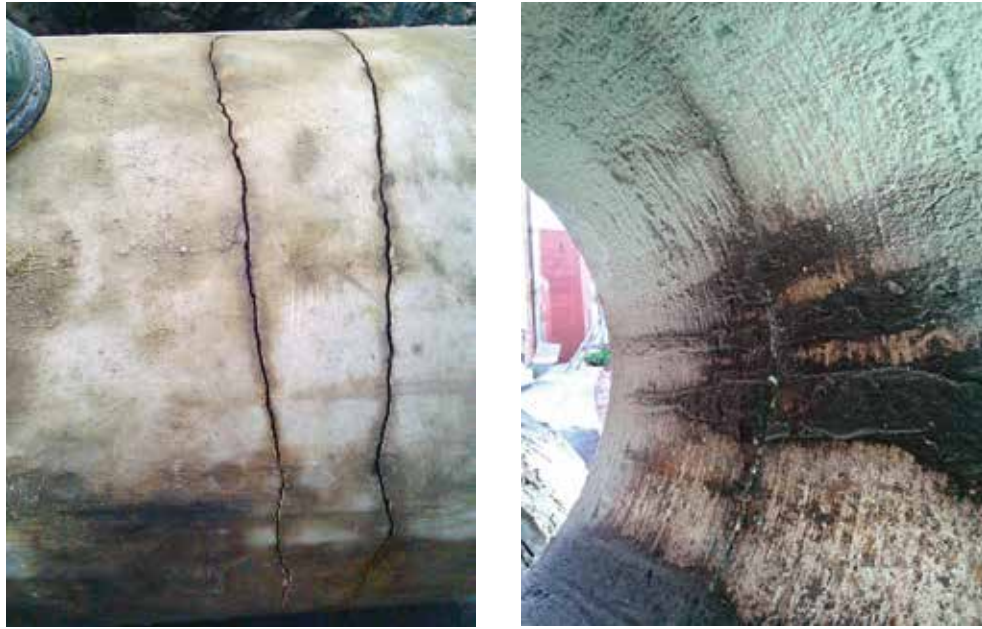
Figuur 3.6 Foto's gebroken persleiding: buitenkant (links) en binnenkant (rechts)
